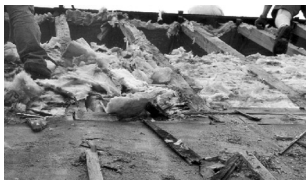
fig. 1.2 Degrado dei materiali a causa di condensa interstiziale (Foto: Peter Erlacher, 1995)
